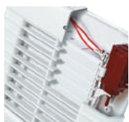
Вентилятор не работает (жалюзи ЗАКРЫТЫ)
