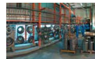
Цех порошковой покраски
