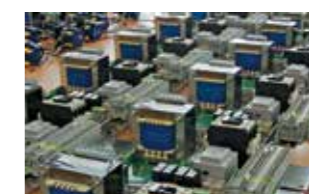
Цех сборки электрооборудования
